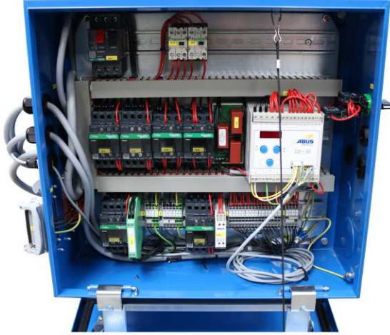
Kontaktör kumandalı ABUS Elektrik 3
