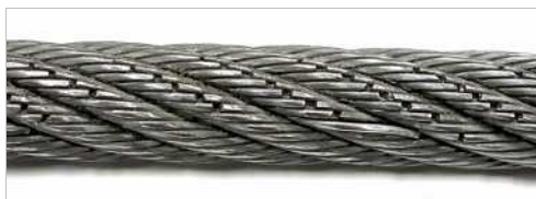
Flera trådbrott. Trådbrott är spår på normalt slitage av linan. De uppstår när linan böjs på grund av att den belastas på linskvorna.
