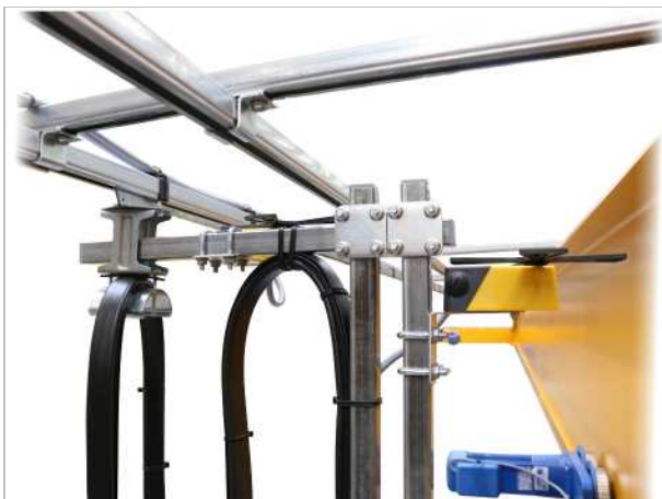
Ristivipukytkin kulkuvaunun rajakatkaisijana
