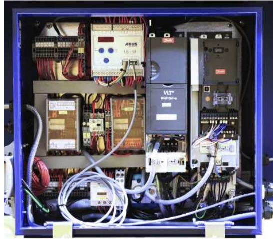
Ajoliikkeisiin ja nostoon tarkoitettulla ABULiner- taajuusmuuttajalla varustettu ABUS-sähköjärjestelmä 3
