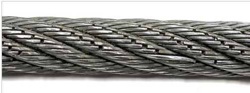
Flere kabelbrudd. Kabelbrudd er tegn på normal slitasje på vaieren. De oppstår når vaieren bøyes på vaierrullene under last.
