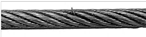
Pęknięcie drutu z odstającym drutem.
