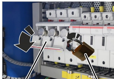
Sezionatore di cortocircuito
